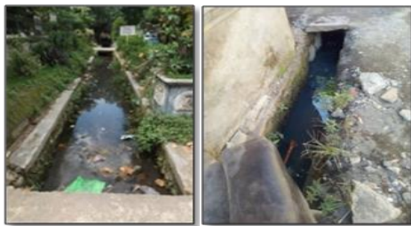
Gambar 8. Kondisi jaringan drainase
