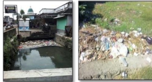
Gambar 10. Kondisi jaringan persampahan
