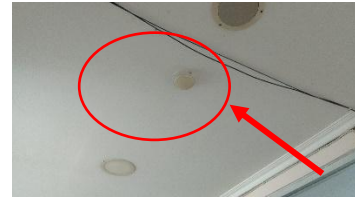
Gambar 8. Alarm detektor kebakaran pada Rusunawa Madiun sebagai proteksi kebakaran Sumber: dokumentasi pribadi
