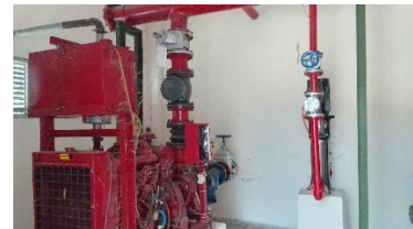
Gambar 9. Pompa darurat sebagai salah satu sistem proteksi kebakaran di rusunawa Madiun Sumber: dokumentasi pribadi
